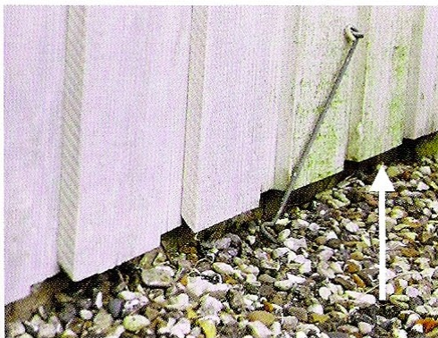
Figur 29 Lodret bræddebeklædning med skrå afskåret endetræ. Hvor skråafskæringen er glemt ses tydelig opfugtning og misfarvning.
