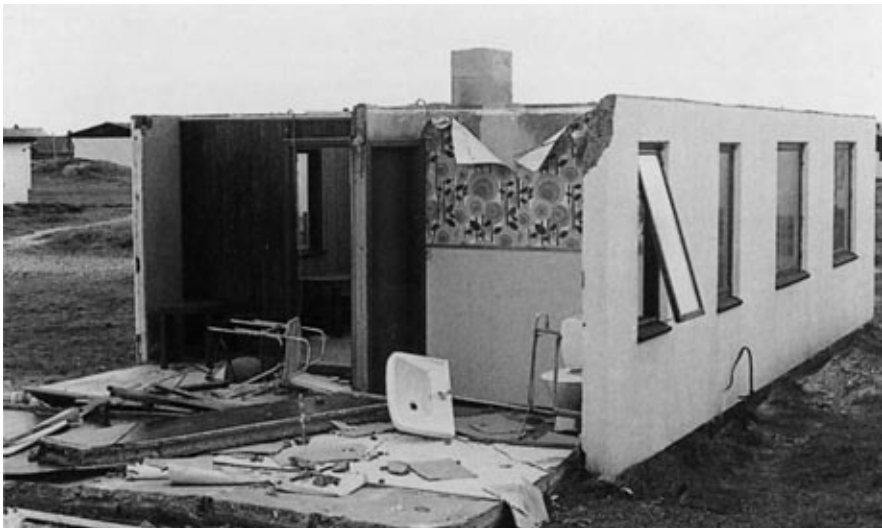
Figur 6. Den lodrette forankring af dette tag var heller ikke tilstrækkelig. Her løftede taget sig så meget, at det ikke faldt ned på sin sædvanlige plads igen.
