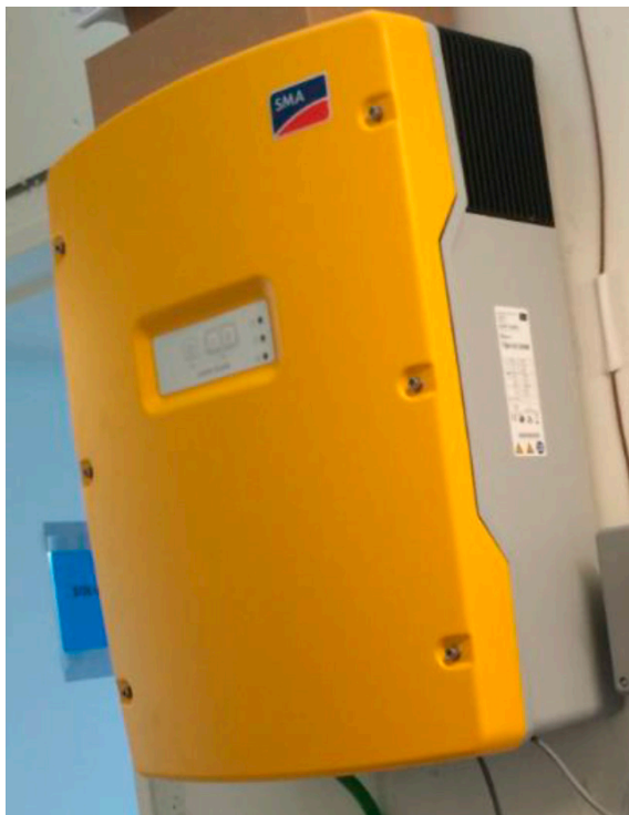
Figur 6. Inverter (Foto: Teknologisk Institut)
