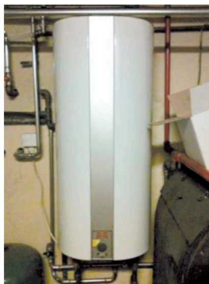
Figur 4. Nyere beholder med varmespiral
